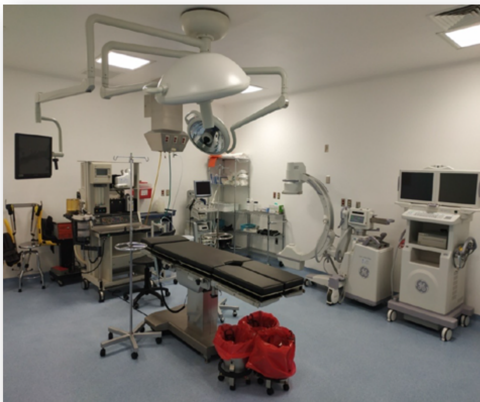
Fig 10. Suite de braquiterapia en bunker quirófano Hospital Español S.B.E.
